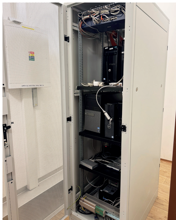
„Mozog“ celého kamerového systému, ktorý dokáže nepretržite sledovať veľkú časť mesta.
