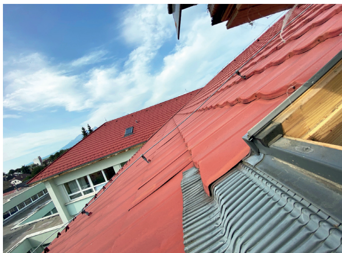
Strecha ZŠ s MŠ Nižná brána, na ktorej má byť osadená fotovoltaika. Snímka zacytená zo strešného okna.
